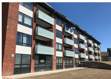
Boligafdelingen Toftemarken, Klintemarken, Frilandsvej i Svendborg, som tester de dynamiske varmeregnskaber, undergår i øjeblikket en renovering. Foto: Domea.dk
